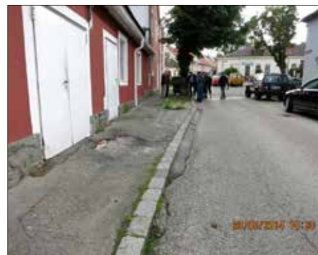
Ebenso oft vorgefunden: Mängel bei Straßenzustand und Gehsteigen – Dreibäusergasse
